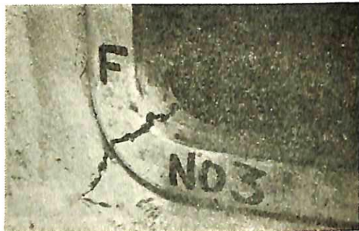
図 I-1-25 架構軽目孔のき裂
