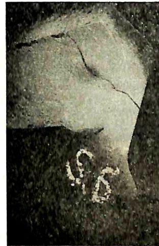
図 I・1・14 B & W 形機関のシリンダ・ジャケット相互の継手部のき裂一下部
