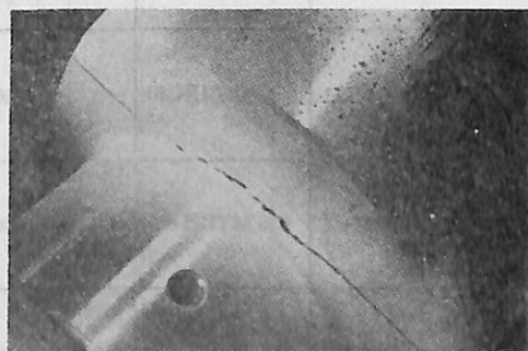
#3 スロー発電機側腕のジャーナル付根フィレット部のき裂および腕点食
