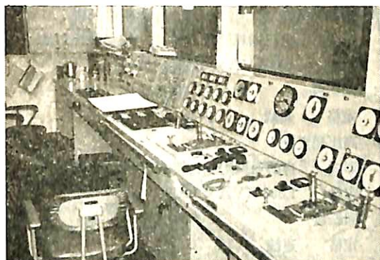
写真-7 機関制御室
