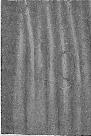
炉壁管の破口及び焼損の状況
