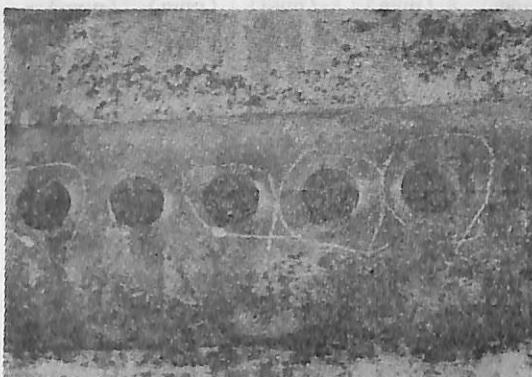
図 III・19 排ガス加熱器ヘッドのガス側の腐食状況
