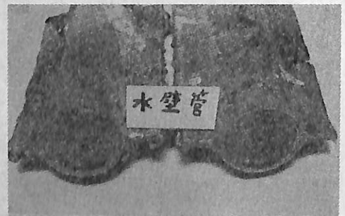
図 III・11 Water wall tube の閉塞状況
