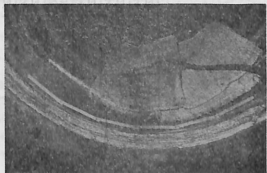
図 III・16 湿燃式丸ボイラ火炉と胴板の間の部分の溶接補修 (腐食によるもの)
