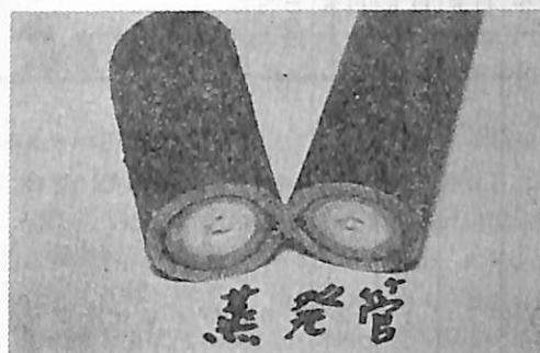
図 III-12 Main bank tube の閉塞状況
