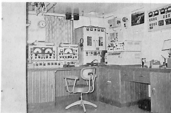
Aデッキ 無線室
