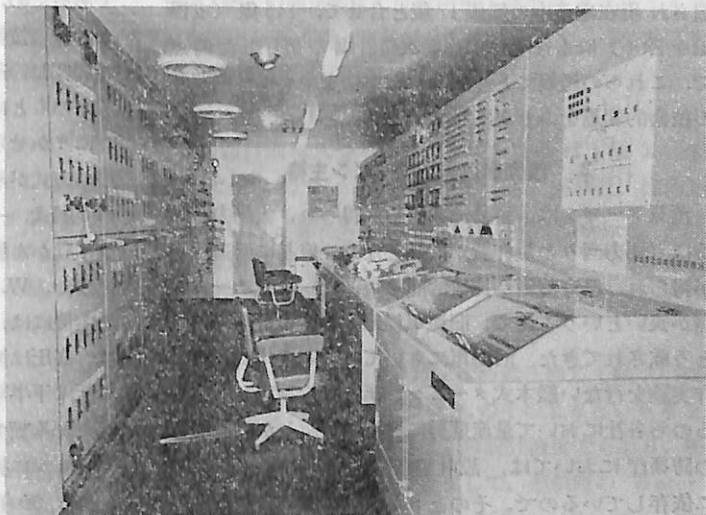
山鶴丸機関自動制御室
