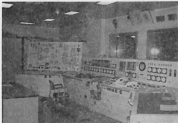
機関部制御室
