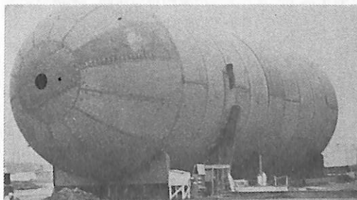
スチールタンクが完成して発泡材被覆を待っている所
