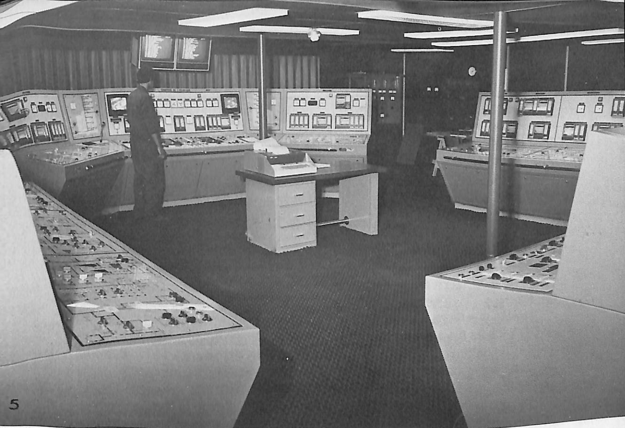
写真⑤は機関の、写真⑥は荷役の遠隔操作室である。
