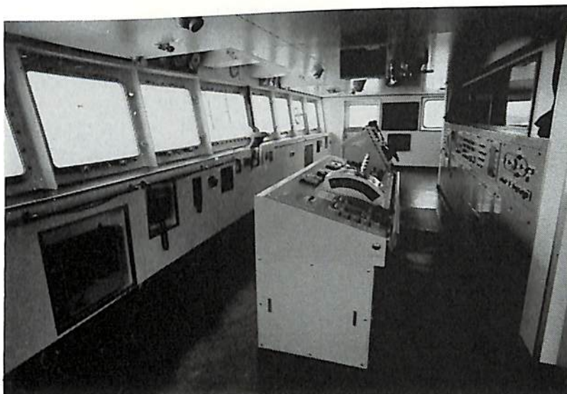
船橋内に設けられた航海コンソール
