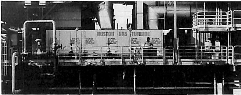
搭載されたコンプレッサ・ステーション
