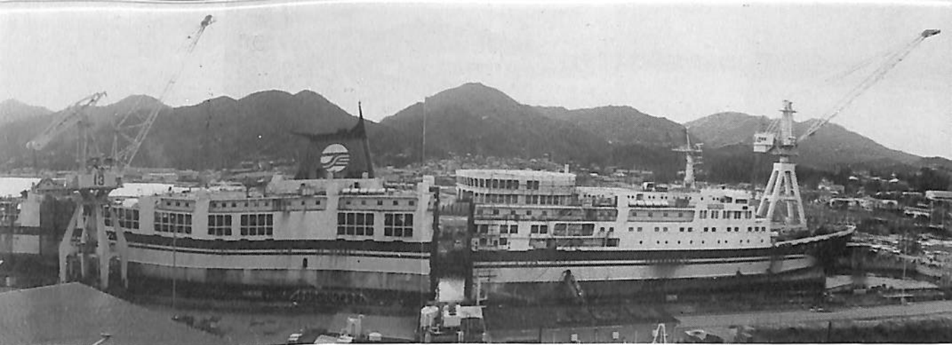
①修繕ドックNo.1に入渠。船体中央部が切断される（工事開始日は1月7日）
