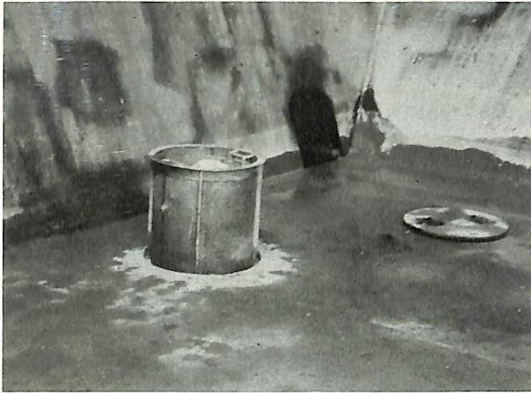
兼用艙のバラスト・サンプ ・タンクのローズ・ボック ス。引抜き式としたので作 業時間が大巾に短縮された。
