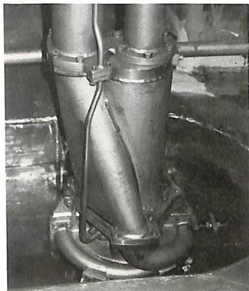
サブマージポンプ（タンク内）
