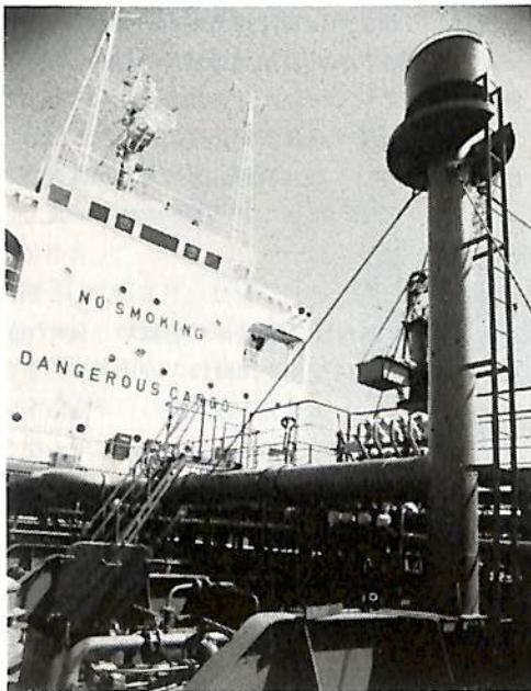
ポンプ室内用排気筒
