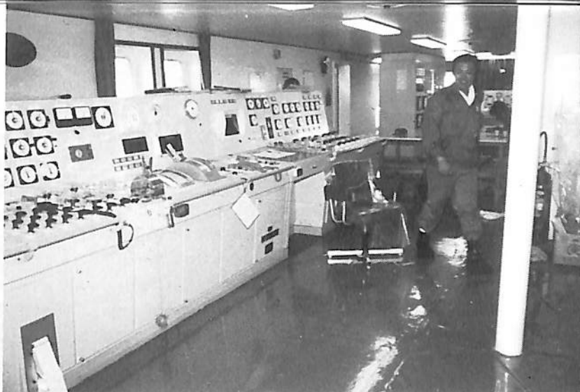
機関制御盤から 荷役制御盤を見る
