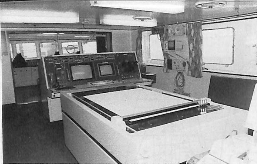
写真2 総合指令室。船首を見る。
