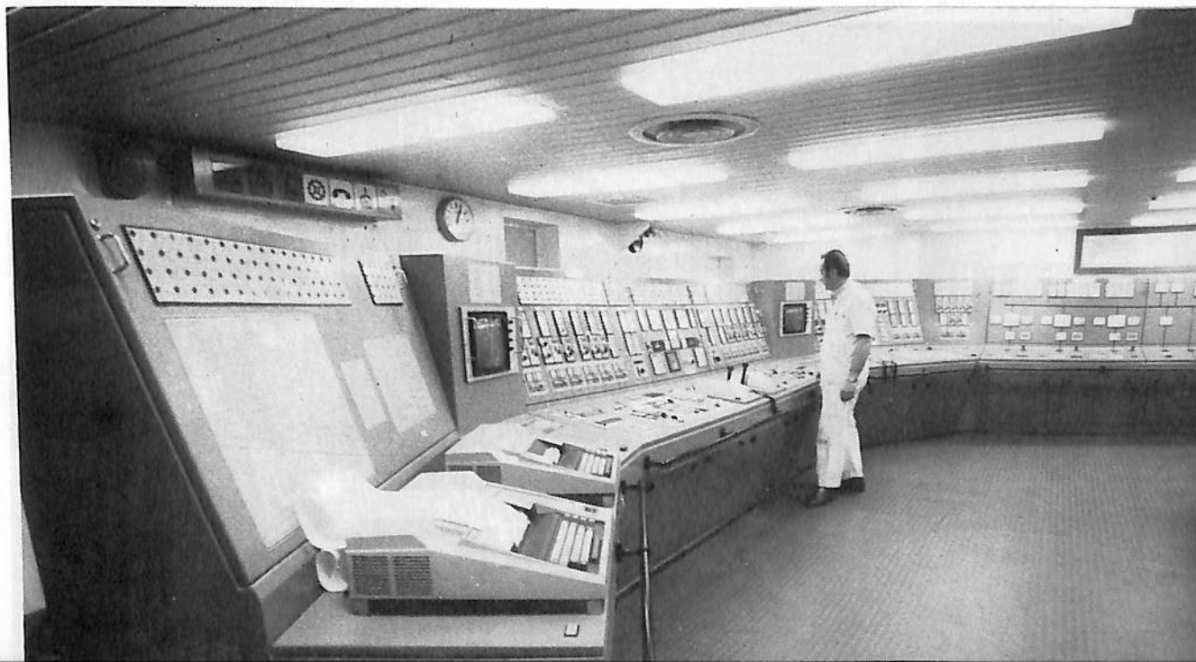
・エンジン・コントロール・センター
