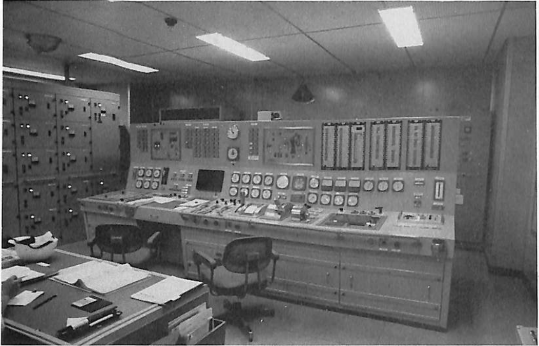
補助機関制御室
