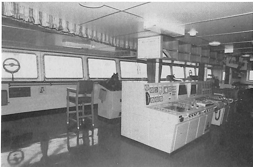
ブリッジ/右手前が機関中央制御盤
