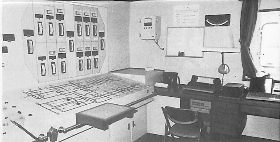
バラスト・コントロール・コンソール
