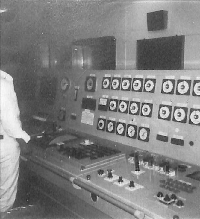
エンジン・コントロール・ルーム
