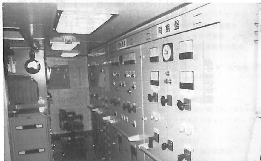
機関当直室の左舷側に配置されている配電盤
