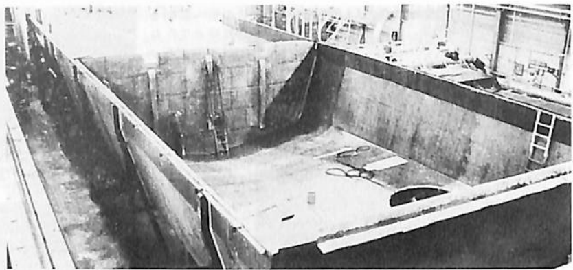
内面の積層完了後、バルクヘッドを所定の位置に成形する
