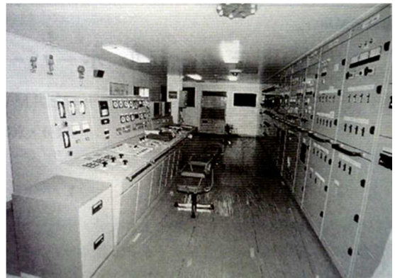
7) W66-07 SALAMINA 機関制御室
