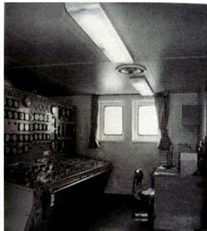
5) W66-05 同左 荷役制御室
