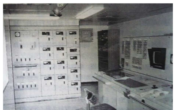
3) W67-03 AIDA 機関制御室
