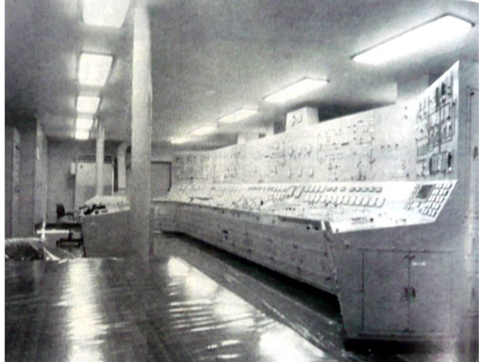
20) W52 - 20 てむず丸 機関制御室
