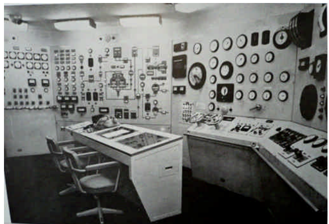
25) W37 - 22 「おりおん丸」機関制御室
