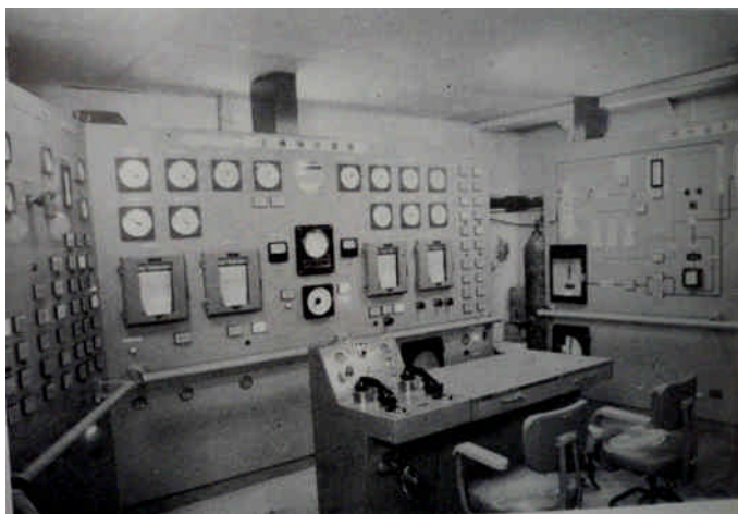
16) W37-15 「山利丸」 機関室内 監視室
