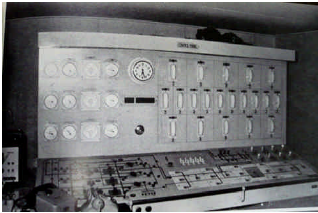
11) W38-11 「竜田丸」貨物油荷役集中制御室
